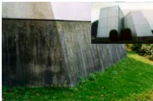
写真－1 暴露した建物とその汚れ状況
