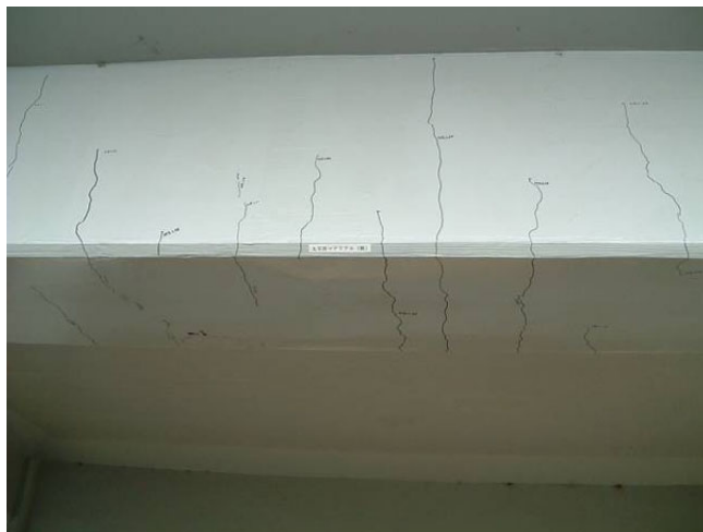
写真－1 縦梁中央部の割れ
