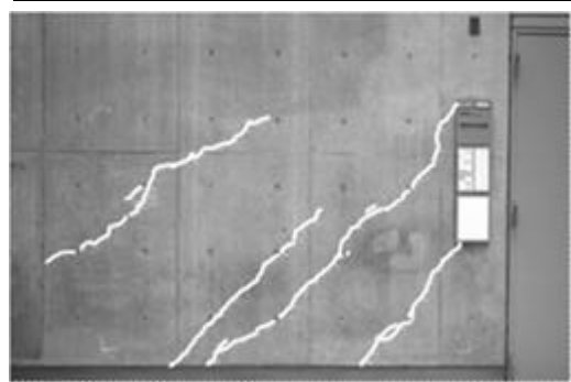
写真 1 7月のひび割れ状況
