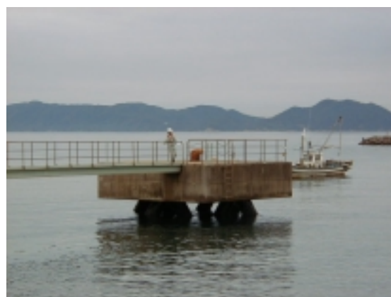
図 1 鉄筋暴露場所（ドルフィン上）
