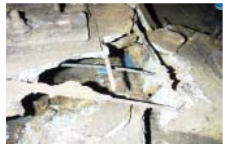
図2 軌道スラブ損傷状態
