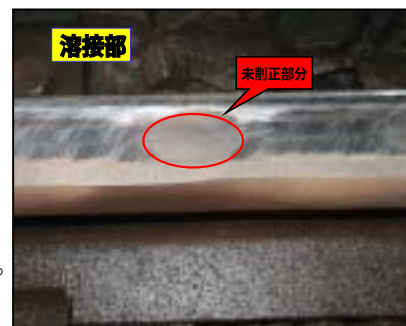
写真-2 未削正部分
