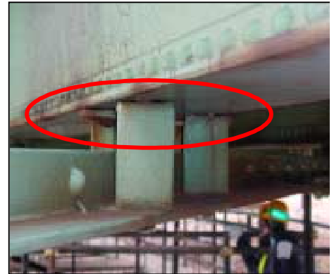
写真-2 縦桁とラテラル連結部リベットの弛み
