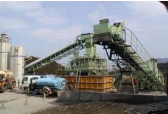
写真－1 回転式破碎混合機プラント全景
