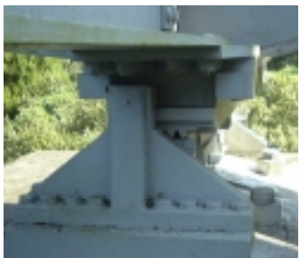
写真 1 地震前の可動支承の様子(P1)
