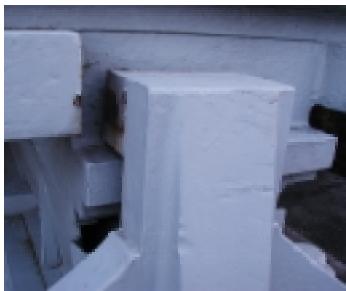
写真 2 地震後の可動支承の様子(P1)
