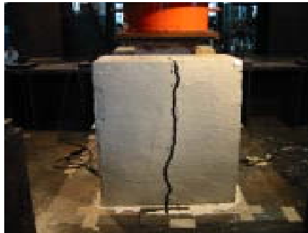
写真-1.終局状況（全景）
