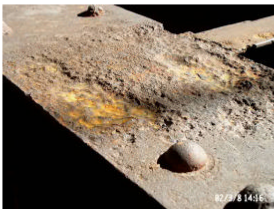
写真1 腐食状況（上フランジマクラギ下面）
