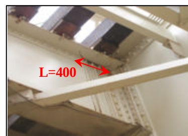
写真 1. 縦桁上フランジの亀裂
