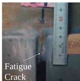
写真-2 発見時の疲労亀裂（2 体目）
