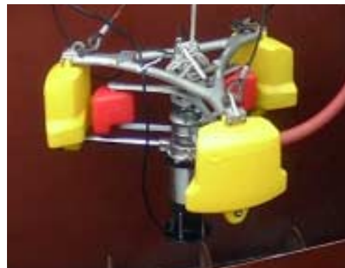
写真-4 浮上油回収ポンプ
