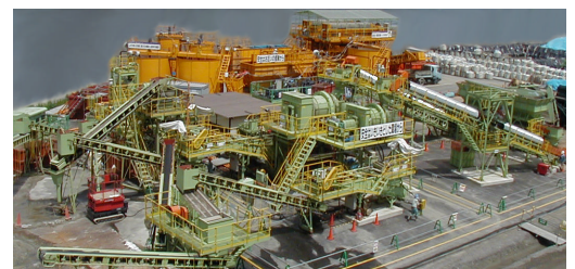
写真-1 分級洗浄プラント全景
