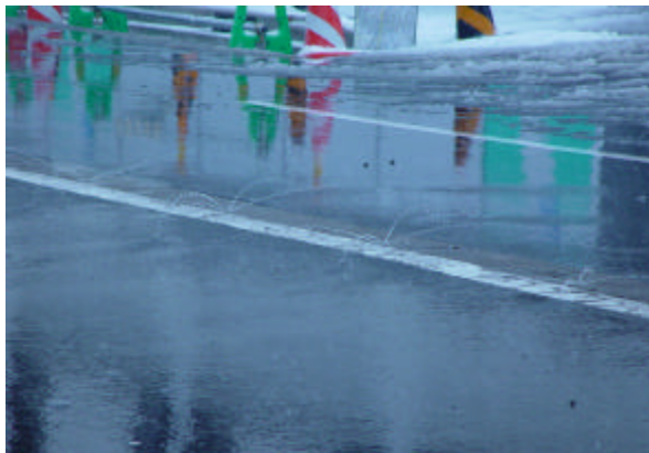
写真 - 5 中央制御による連続散水区間の状況
