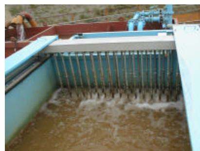
噴射ノズルによる酸化状況
