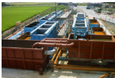
強制曝気自然ろ過方式除鉄装置
