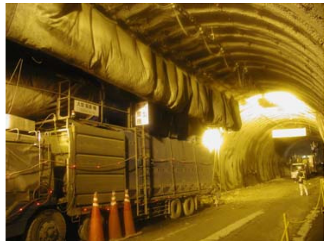
写真-1 大型集塵機（RE-1500P改良型）と移動式風管（折りたたみ時）
