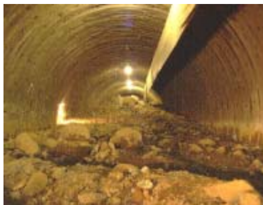
写真1 崩落発生直後の坑内状況
