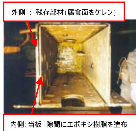
写真 - 2 樹脂継手の断面
