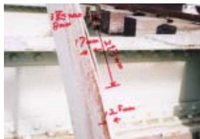
写真-2 層状剥離
