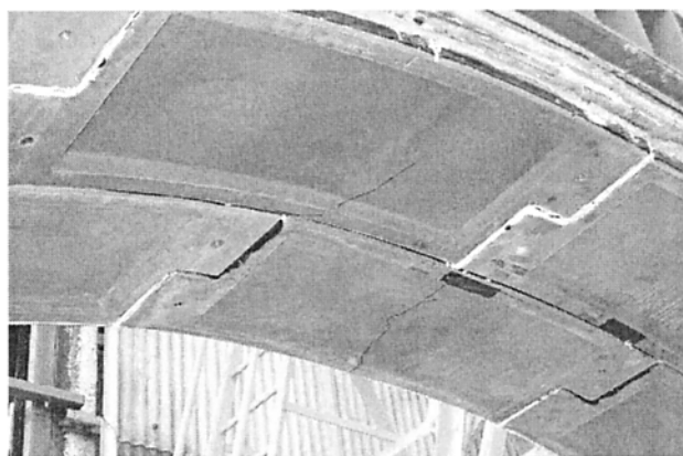
写真1 破壊状況（クラウン部）
