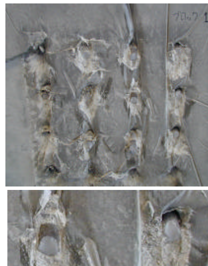
図-4 ずれ止め鉄筋の破断状況 （下段は破断部の拡大写真）
