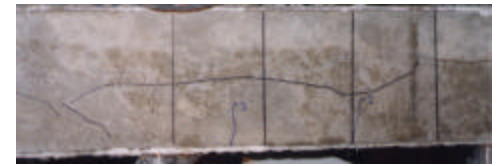
写真-2 初期ひび割れ(軸方向)
