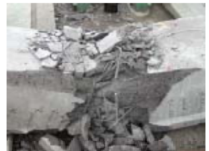
写真-4 破壊状況
