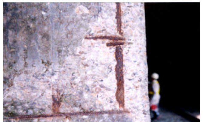
写真 - 1 鉄筋露出箇所
