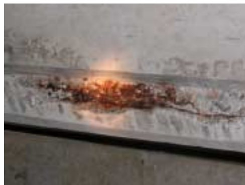
写真 1 変状部分の鉄筋腐食状態
