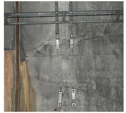
図-3 コンクリート剥離箇所
