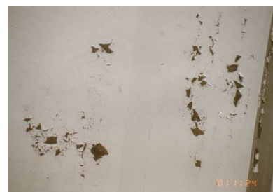
写真-1 表面被覆材の劣化
