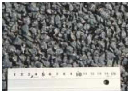
写真-1 新規排水性舗装表面（4ヶ月経過）
