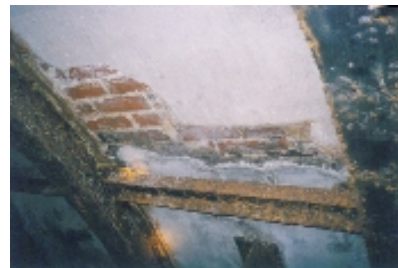
写真2 吹付けモルタルの剥落箇所
