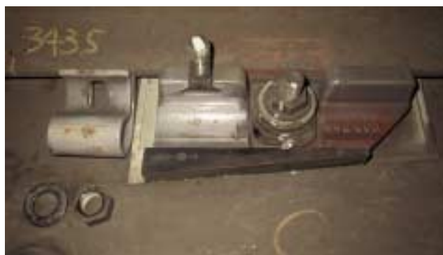
図6 敷設後1年半後の締結装置の状態
