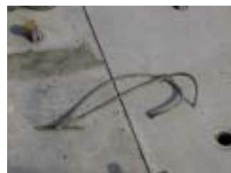
写真10 新旧スラブ間の隙間
