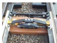
転換装置類をまくらぎ直上に配置
