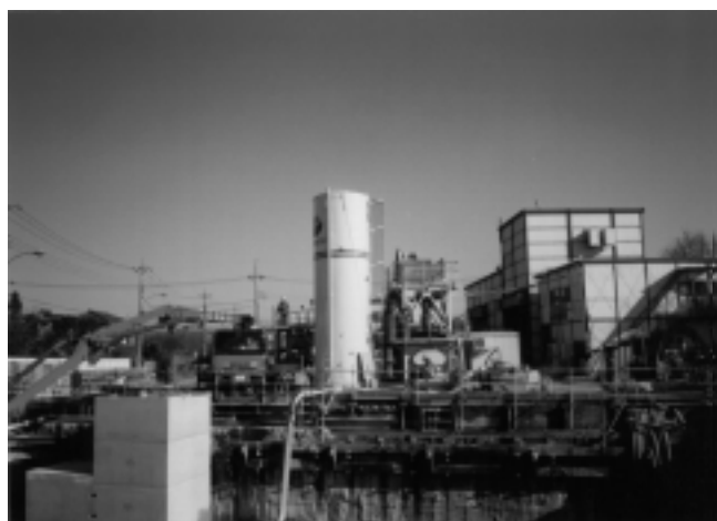
写真-2 流動化処理土製造プラント
