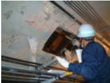
写真 2.1 二次覆工の剥ぎ取り箇所
