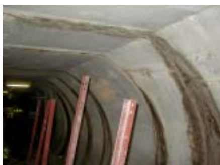
写真 1.2 築後 23 年経過（東京）
