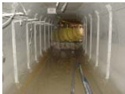
写真 1.1 築後 13 年経過（福岡）
