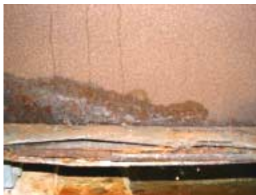
写真 - 1 層状剥離錆
