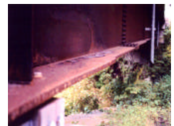
層状さびの状態
