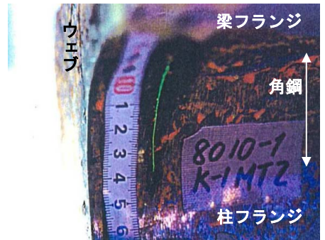
写真-2 タイプ1の事例（き裂 B）
