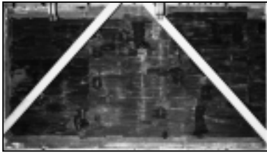
S4992 (15年経過) 2方向ひび割れが確認され、局 部的な遊離石灰も見られる
