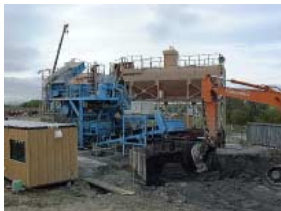
写真 - 2 汚泥改良設備全景
