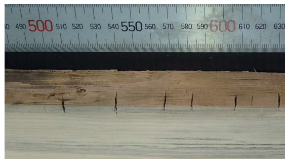
写真 - 1 木杭表面における腐朽状況
