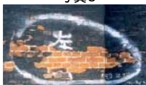
写真2 表面劣化の剥落
