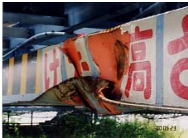
写真-1 下弦材変状状況
