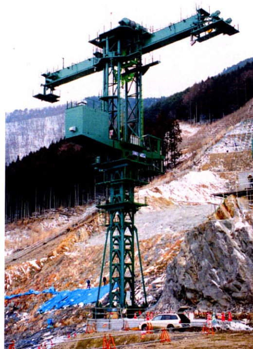
写真ー1 設備全景
