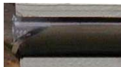
写真-3 一部空隙あり
