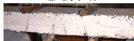
写真-2 版供試体ひび割れ状況
