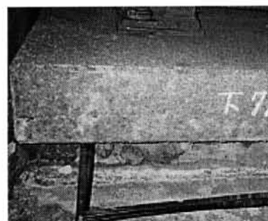
写真1 既設CAM劣化状況
