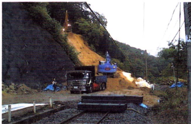
写真-3 斜面の再崩壊(根妻付近)
