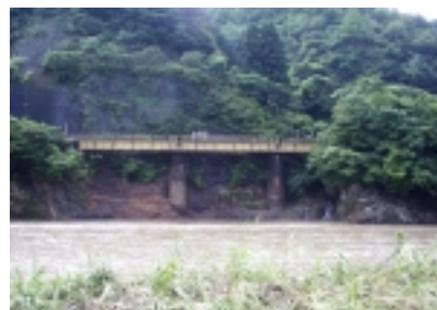
水郡線滝沢川橋りょう洗掘災害
